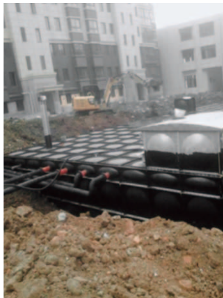
辽宁省龙泉口酒业有限公司泵站
