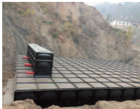
河北顺嘉房地产泵站
