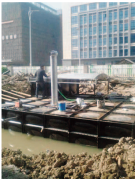
苏州吴江同陈水电维修公司泵站
