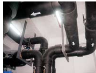
上海中心机房顶板
