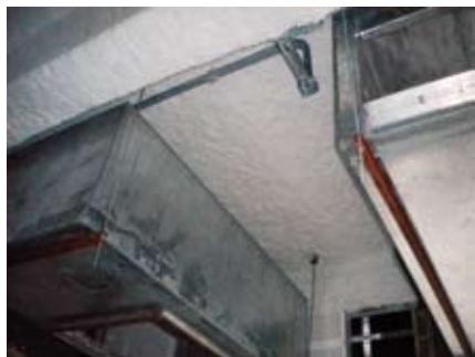
厦门海峡交流中心、建发大厦机房
