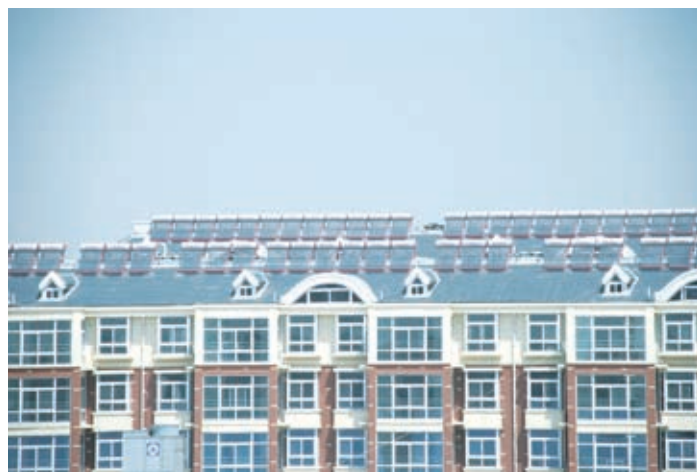
河南鹤壁市四季青小区 工程类型：一体机系统 规模：550m 2
