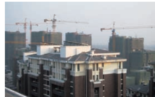
青岛万科城市花园项目 工程类型：集中集热分户贮热 规模：2000m 2
