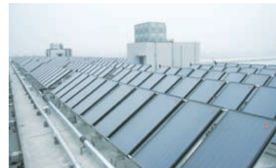
安徽合肥海尔冰箱职工宿舍楼 工程类型：平板集中供水系统 规模：640m 2
